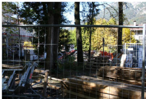
Lagerung von Baumaterial und Fahrzeugen / Kränen im Kronenbereich von Bäumen führt zu Verdichtung im Wurzelbereich und zu Schäden an Kronen und Stämmen. Dadurch kommt es zu Folgeschäden bis zum Absterben des Baumes.
