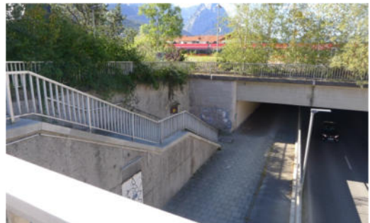
Abweisende Unterführung an der St.-Martin-Straße
