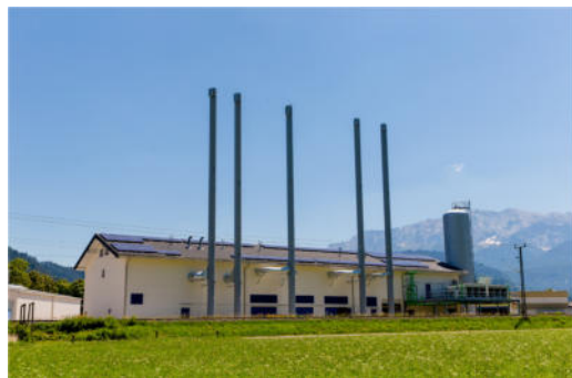
© Gemeindewerke Garmisch-Partenkirchen, Fernwärmeanlage
